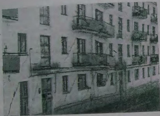
Рис. 30. Деформации здания, построенного на сваях, оставленных в просадочных грунтах после их замачивания
