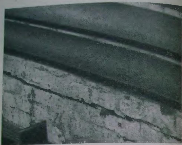
Рис. 31. Горизонтальный отрыв свайного фундамента от цокольной части при оставлении нижних концов свай в торфях
